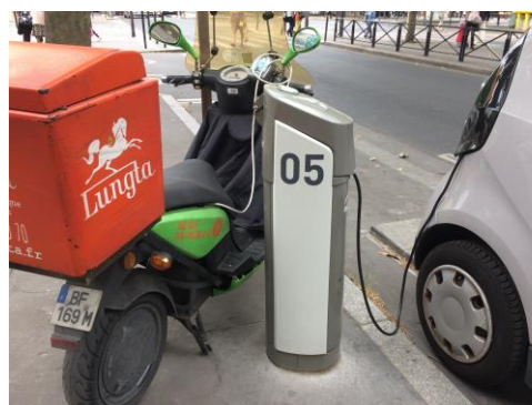
Prises de rechargement électrique pour autos et scooters
